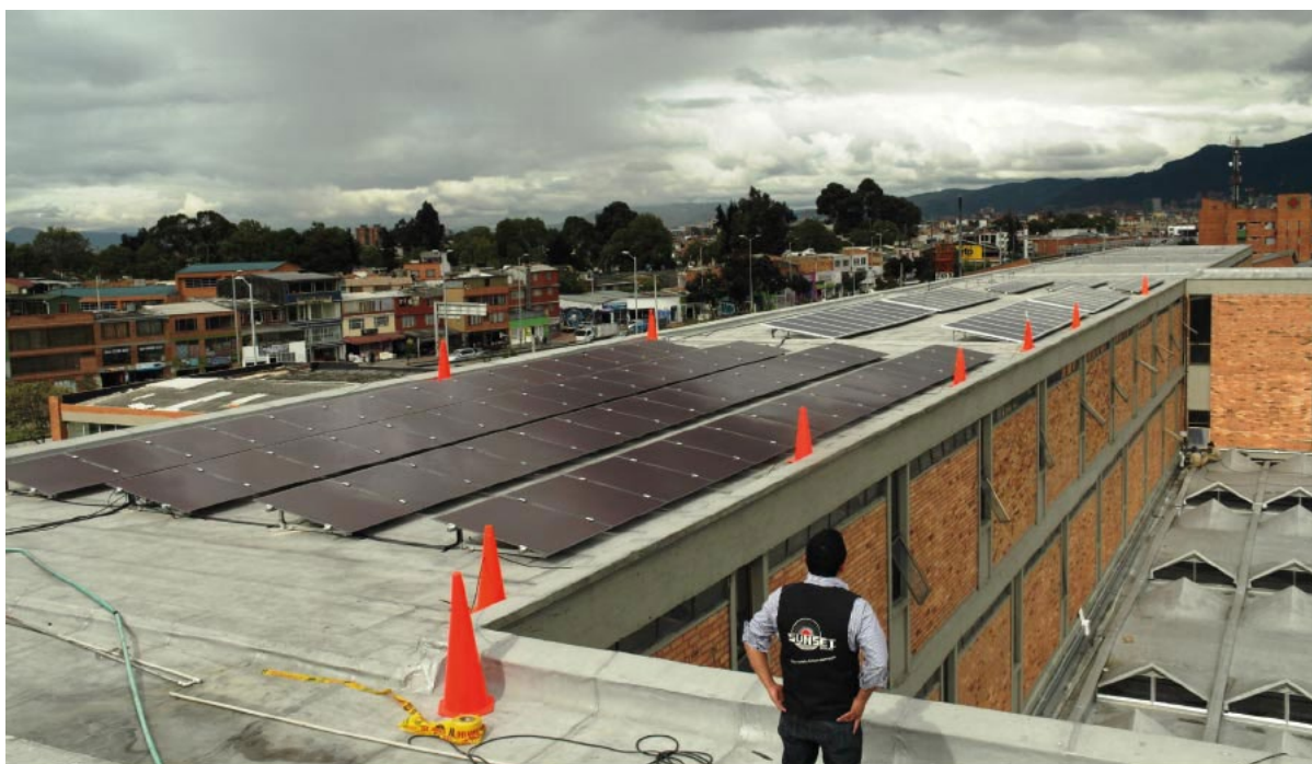
SUNSET Solar – Schulungsanlage in Bogotá
